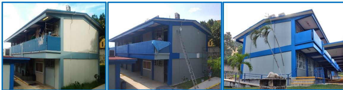
Antes de la rehabilitación
