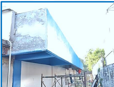
Antes de la rehabilitación
