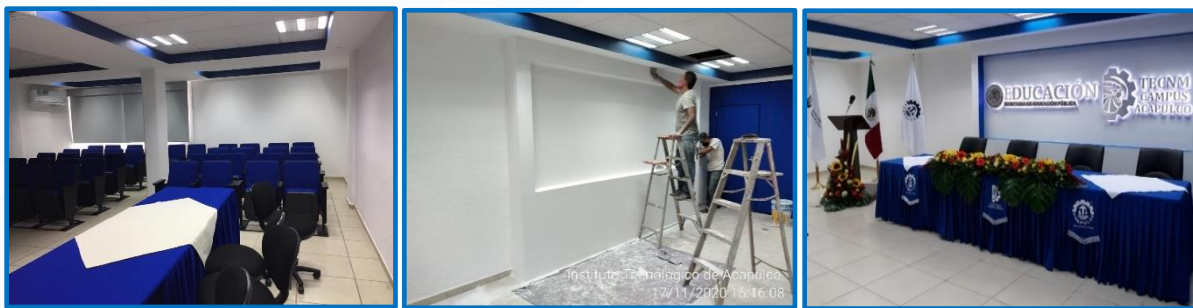
Antes de la rehabilitación
