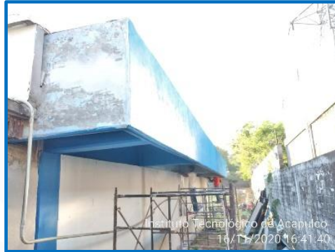
Antes de la rehabilitación
