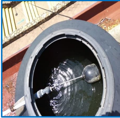
Antes de la rehabilitación
