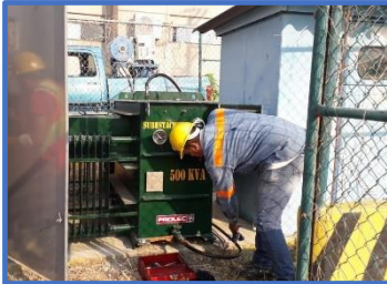
Antes de la rehabilitación
