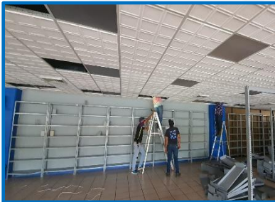
Antes de la rehabilitación
