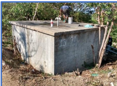
Antes de la rehabilitación
