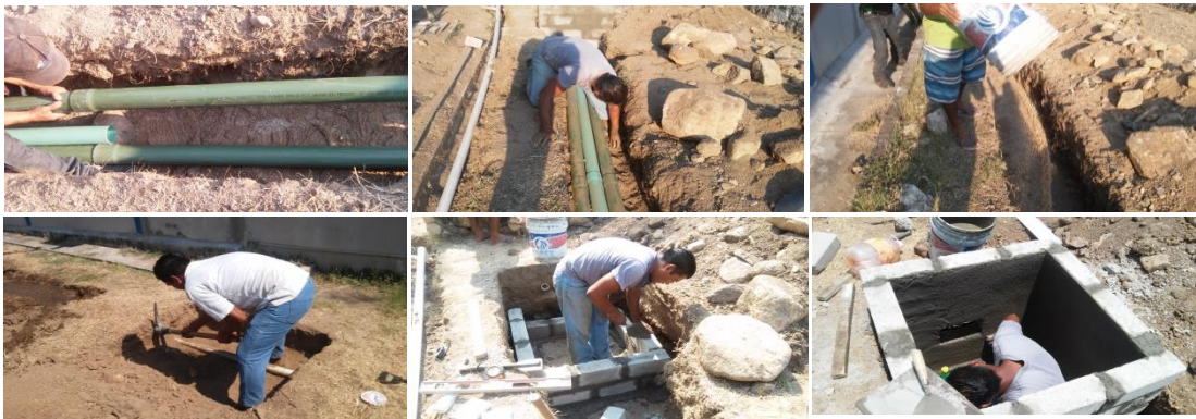
Canalización y obra civil para la interconexión de la red de fibra óptica
