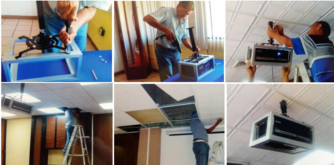
Mantenimiento a falso plafón, pisos y pintura de la sala de titulación
