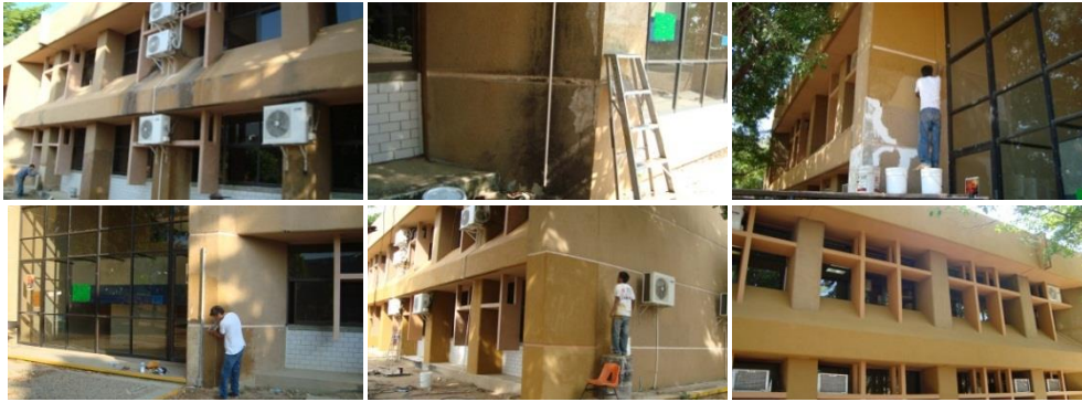
Mantenimiento de eficio de los 700's
